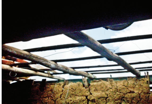
FIGURA 3 – Telhado adaptado para a pesquisa
