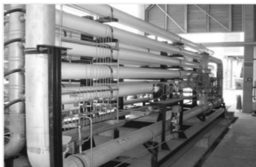
Figura 3 – Imagem da Osmose Reversa da Petrobras
